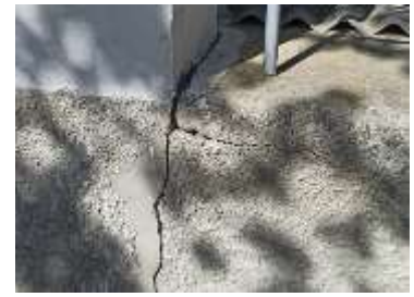
Рис. 11. Деформации верхнего камерального павильона. Фото 2025 г.
