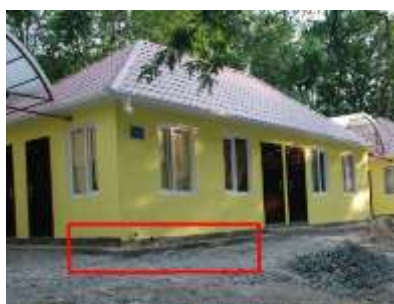
Рис. 7. Деформации домиков постройки 2009 года. Фото 2005 г.
