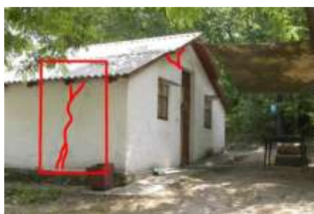
Рис. 6. Деформации домиков постройки 1975 года. Фото 2005 г.
