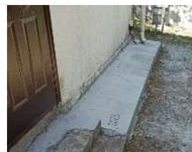
Рис. 8. Деформации домиков постройки 2009 года. Фото 2025 г.
