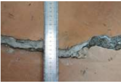
Рис. 9. Трещины в полу верхнего камерального павильона. Фото 2025 г.
