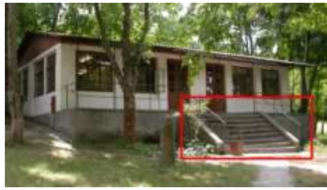
Рис. 10. Деформации верхнего камерального павильона. Фото 2005 г.
