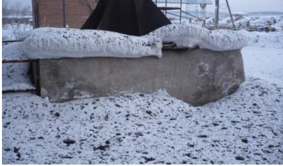
Рис. 1 – Вынос несгоревшего топлива из дымовой трубы
